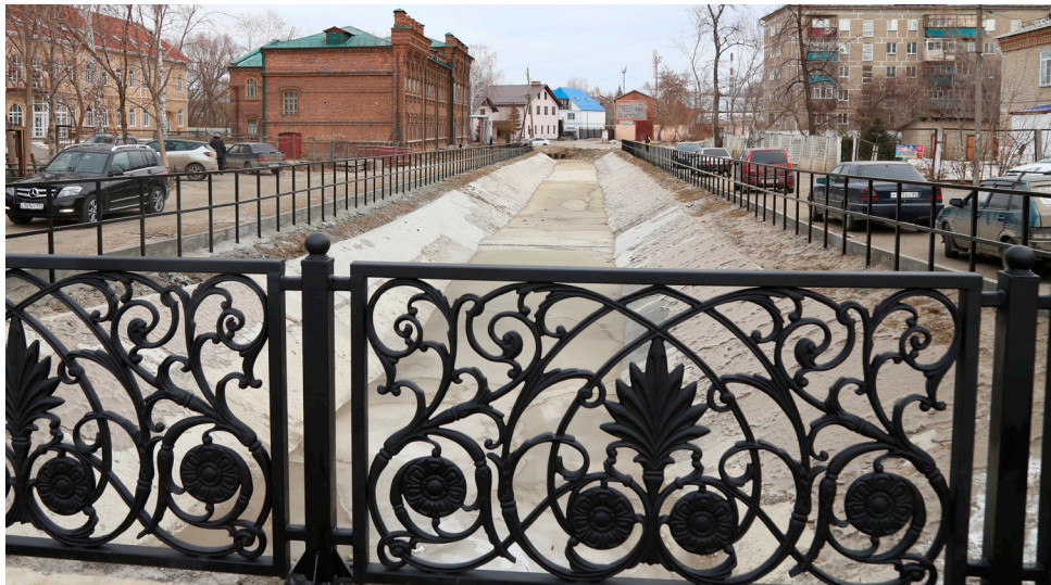
На северном водосбросном тракте речки Кыштымка заменены затворы, выполнен ремонт сооружений канала. Предстоят работы по благоустройству.
